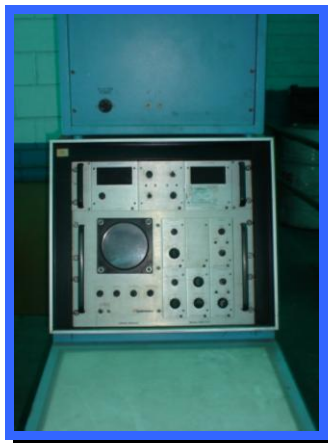
Fig. 68 Equipo detector de descargas parciales de mayor data.
