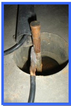
Fig. 3 Barra de tierra coperwell externa.
