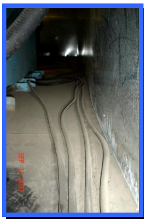
Fig. 82 Cables de conexión a tierra de varios equipos que intervienen en la prueba.
