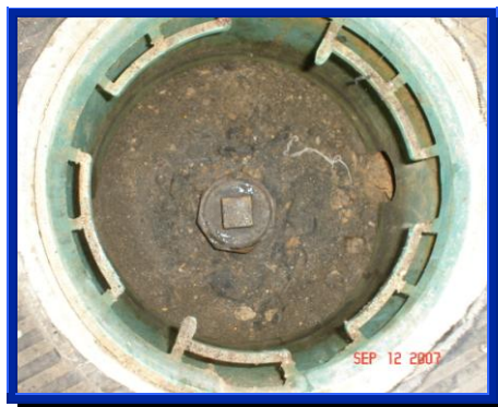
Fig. 87 Barra CHEM – ROD® del sistema de puesta a tierra de la Jaula de Faraday.
