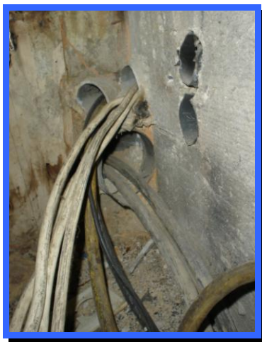
Fig. 85 Entrada y salida de cables a la fosa de radiofrecuencia.
