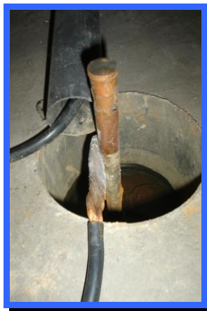
Fig. 69 Barra de tierra coperwell externa.
