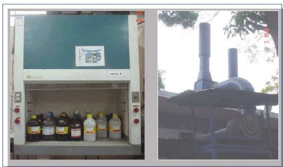
Figura 4.7: Campana utilizada como almacenamiento temporal de los reactivos líquidos del LFQ (izquierda), Ductos de ventilación y extractor de gases de dicha campana (Derecha)
