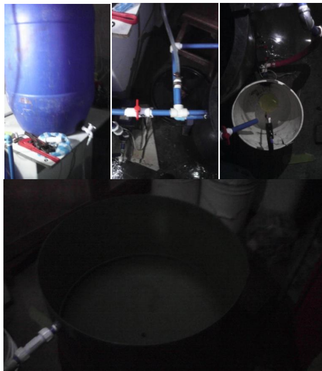
Figura 11. Equipos instalados: tanque de alimentación de agua por gravedad, distribución de líneas de alimentación y recirculación, tanque pulmón con bomba y sedimentador.
