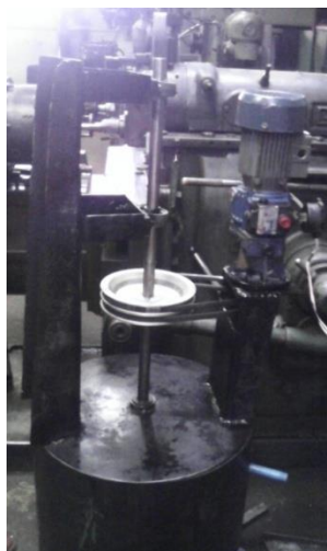
Figura 8. Conjunto motor, reductor de velocidad y eje del mezclador del reactor anóxico.
