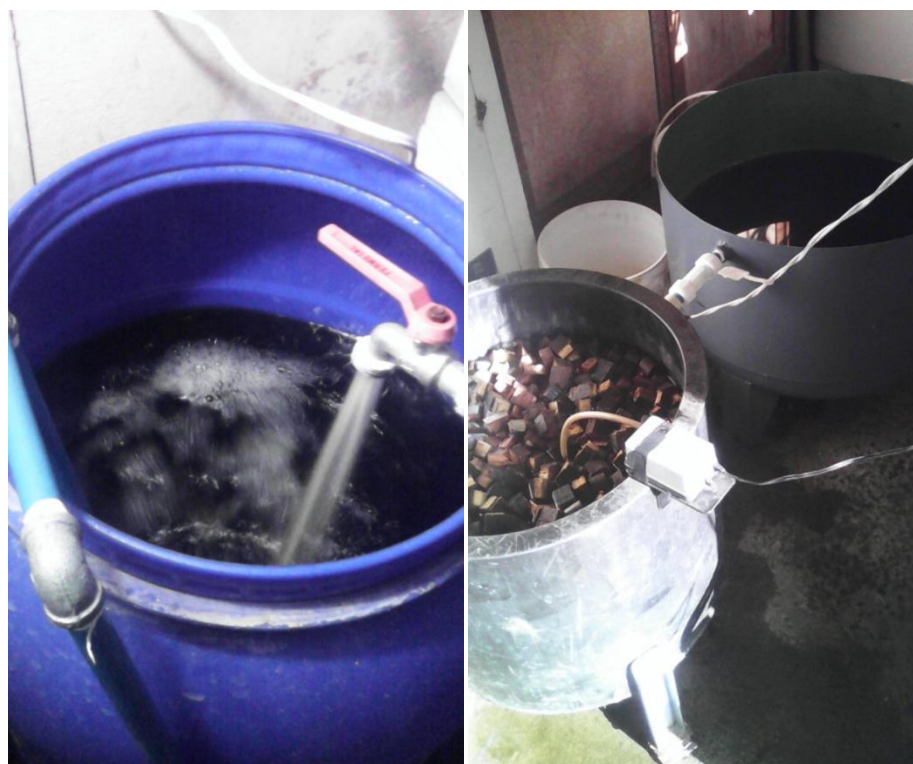
Figura 12. Equipos instalados en operación.
