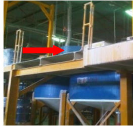
Figura N° 39. Mezzanina #1 sin barandas
