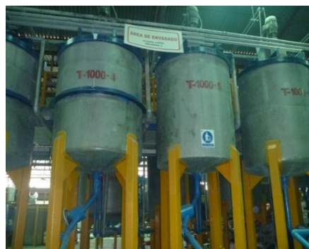
Figura N° 19. Tanques Tt-1000 (Cap: 1000gal)
