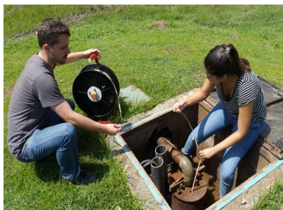
Figura 41. Medición y Lectura de niveles en el Pozo # 3 de Villas de San Diego Country club. Coordenadas 615.974,25 E; 1.137.460,67 N, elevación 495 m.s.n.m Municipio San Diego, Estado Carabobo. Fecha: 24/10/2016. Fuente: Los Autores.
