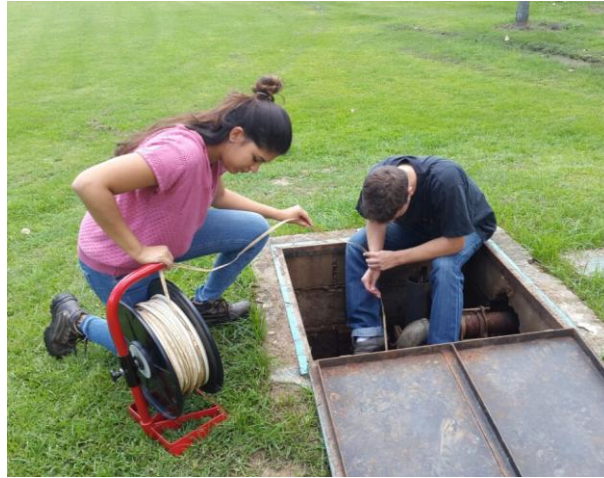
Figura 38. Medición y Lectura de niveles en el Pozo # 3 de Villas de San Diego Country club. Coordenadas 615.974,25 E; 1.137.460,67 N, elevación 495 m.s.n.m Municipio San Diego, Estado Carabobo. Fecha: 24/09/2016. Fuente: Los Autores.
