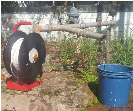
Figura 6. Pozo #6 perteneciente al A.C conjunto residencial El Tulipán. Coordenadas 613.536,88E; 1.134.540,80 N, elevación 480 m.s.n.m, Municipio San Diego, Estado Carabobo Fuente: Los Autores
