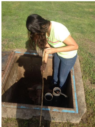
Figura 40. Medición y Lectura de niveles en el Pozo # 3 de Villas de San Diego Country club. Coordenadas 615.974,25 E; 1.137.460,67 N, elevación 495 m.s.n.m Municipio San Diego, Estado Carabobo. Fecha: 01/10/2016. Fuente: Los Autores.
