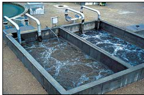
Figura 2.3 Tanque de Igualación
