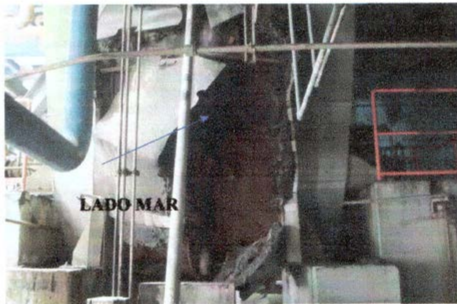
Figura B.8 Ventiladores de recirculación
