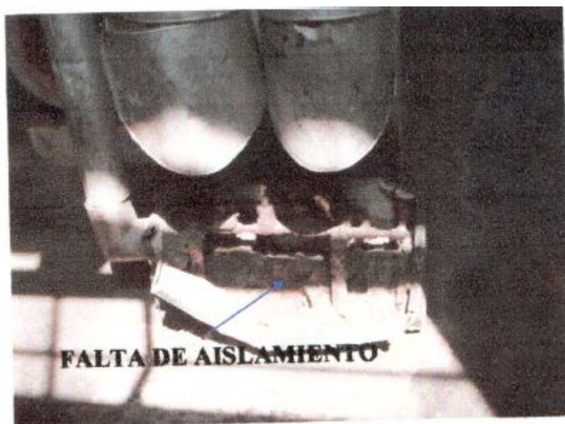
Figura B.6 Falta de Aislamientos en Tuberías
