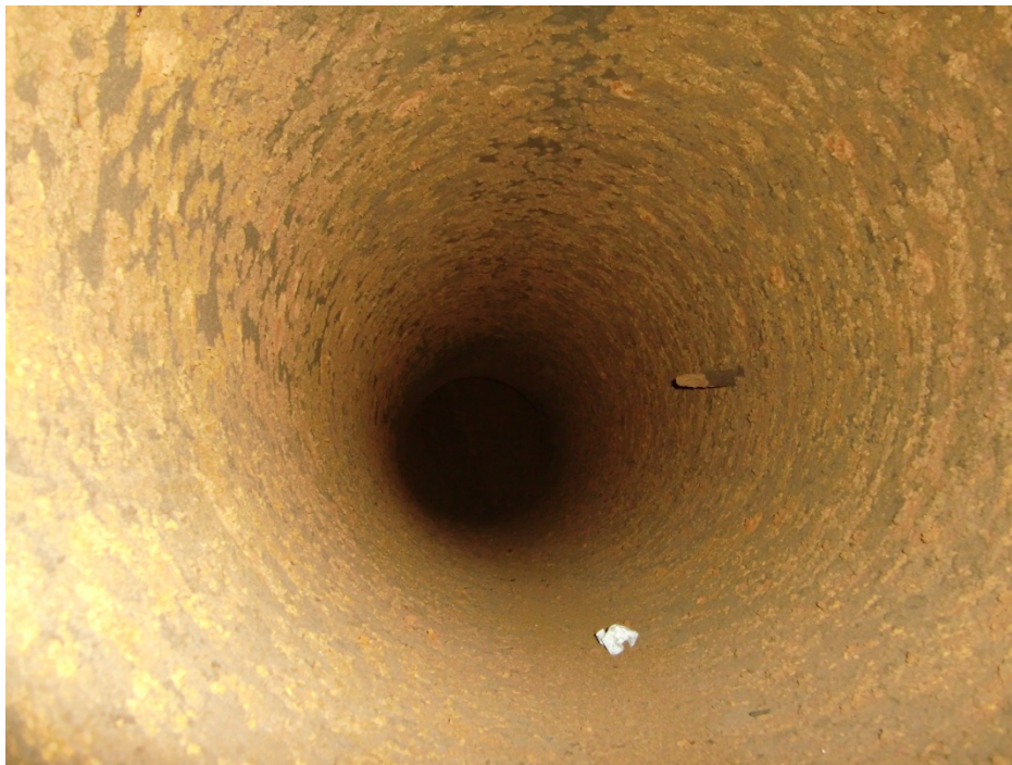
Figura B.11 Tubería de succión agua de Mar
