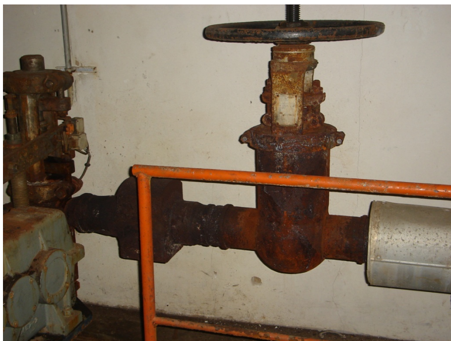
Figura B.5 Falta de Aislamiento en las Válvulas
