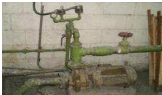
Figura 4.10. Bomba (M203) de Rociado de Agua
