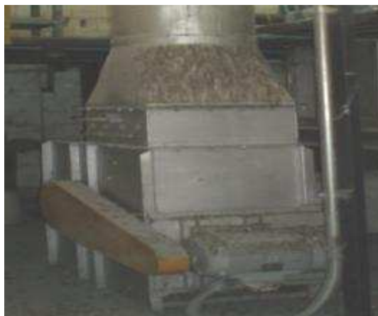
Figura 4.9. Motor (M103) Extractor de Aire
