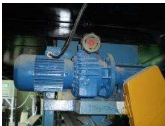
Figura 4.13. Motor (M205) de Vibración
