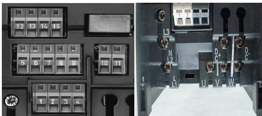
Figura 4.50. Borneras de Conexiones Eléctricas del Micro Máster 420
