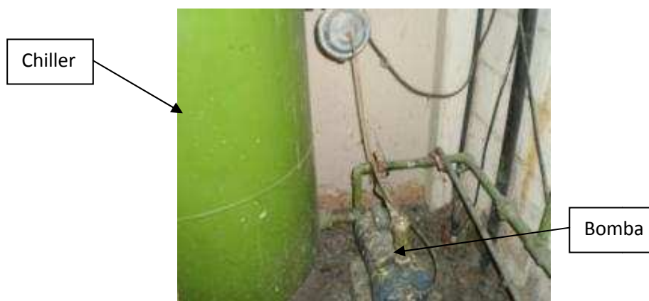
Figura 4.19. Chiller y Bomba (M402) de Enfriado
