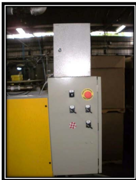
Figura 4.15 El cajetín agregado y el gabinete de control
