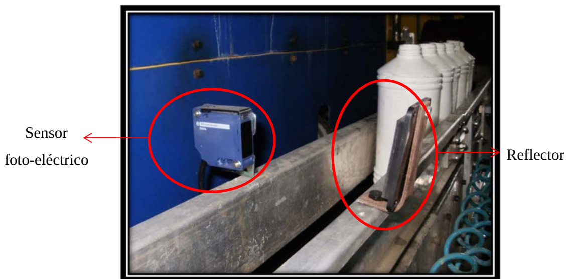
Figura 4.8 Sensor foto-eléctrico instalado
