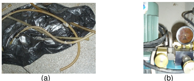
Figura 4.56. Estado inicial de las tuberías flexibles del banco. (b) Manómetro deteriorado
