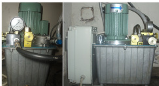
Figura 4.2. Unidad de fuerza del banco electro-oleohidráulico.
