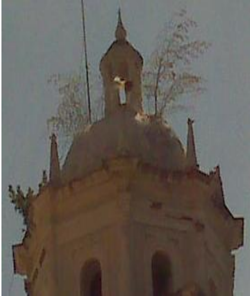
Deterioro de la Torre Norte de la Catedral
