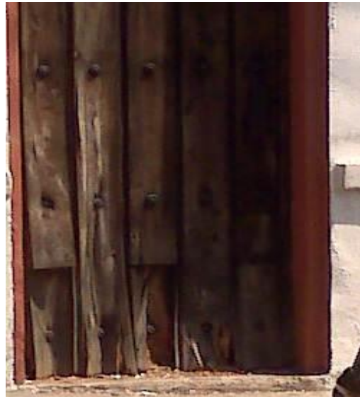
Deterioro del portón
