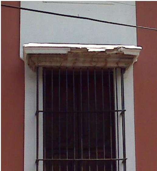
Deterioro de una de las ventanas
