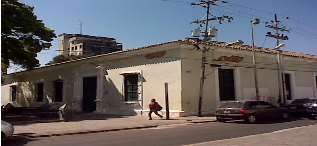
Deterioro de la fachada de la casa de los Hernandez Monagas
