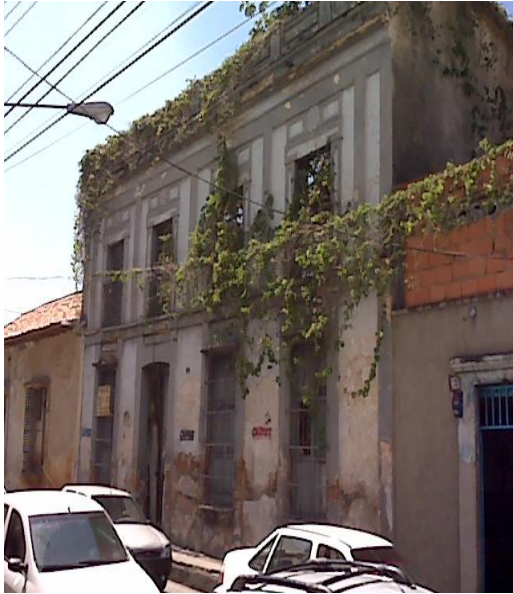
Casa de estilo colonial en ruina Avenida Martín Tovar
