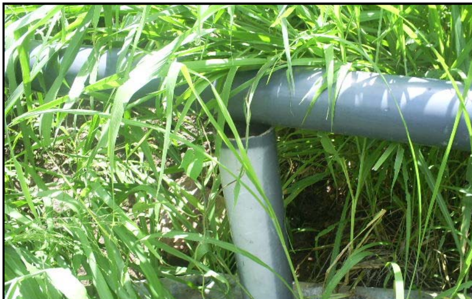
Figura 28. Apoyos improvisados de la línea de distribución Dique la Fabianera.
