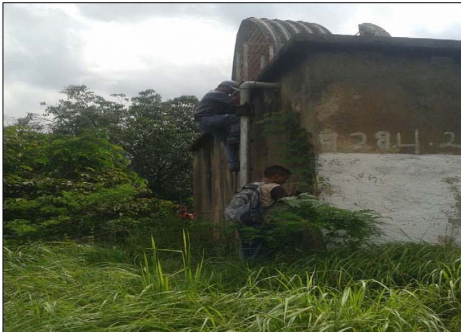
Figura 16. Tanque de almacenamiento del Dique toma sector La Manga
