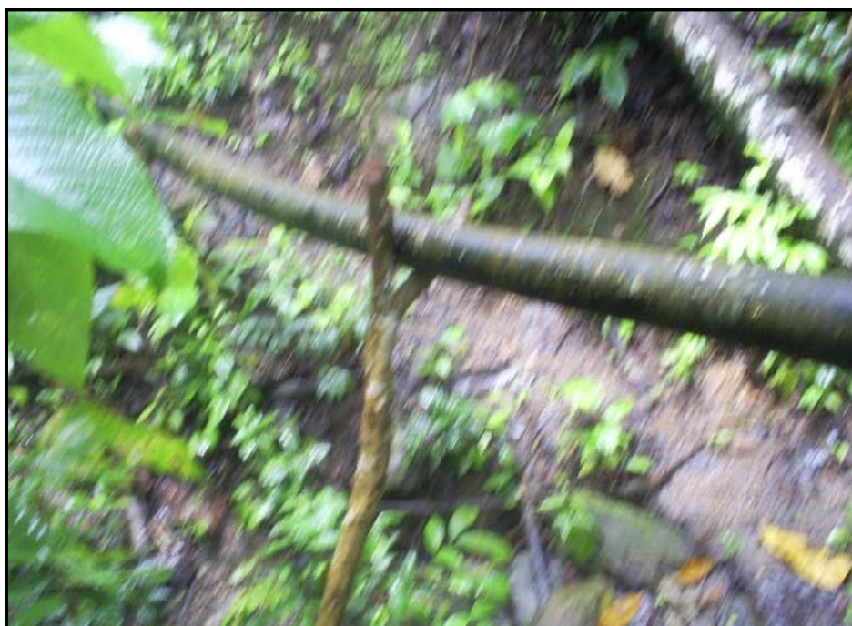
Figura29. Apoyos improvisados de la línea de distribución Dique la Fabianera.
