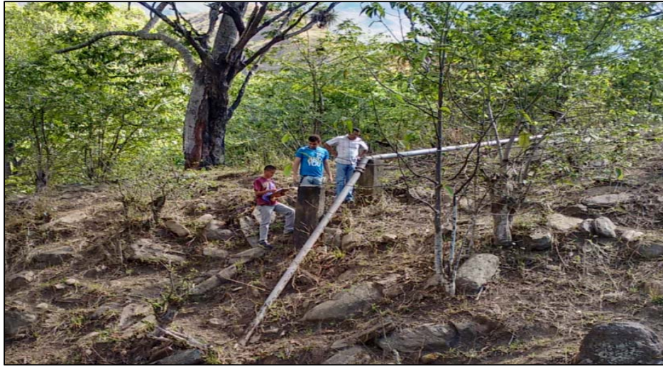
Figura 10. Accesorios y cambios de dirección tubería de aducción Dique toma sector La Manga.
