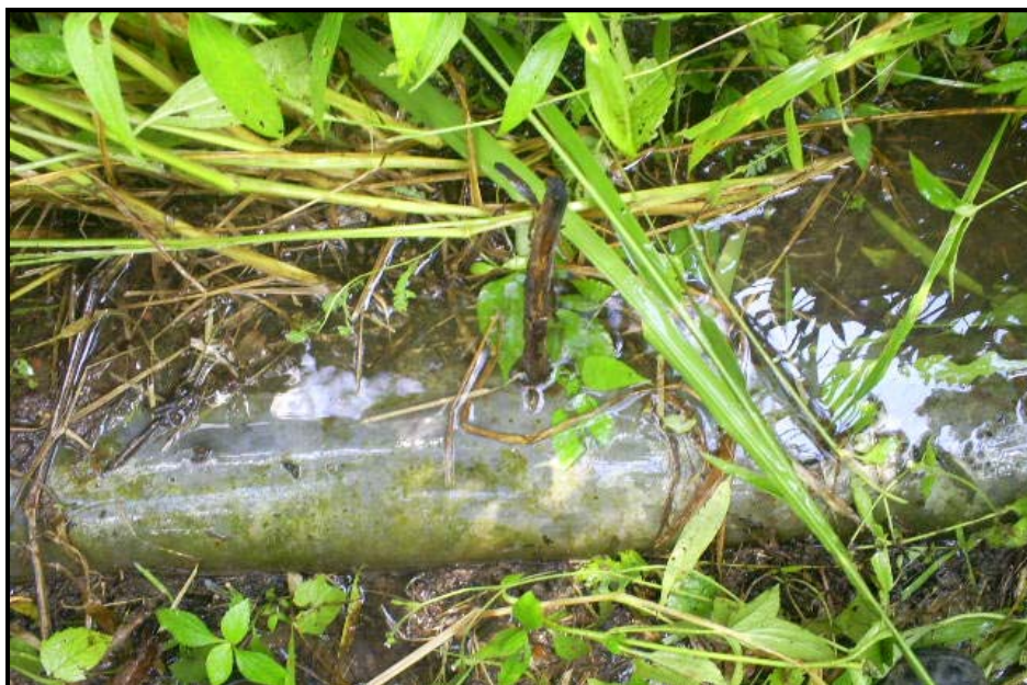
Figura 30. Fugas en la línea de aducción Dique la Fabianera.
