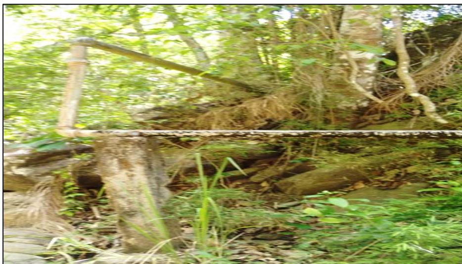
Figura 11. Accesorios y cambios de dirección tubería de aducción Dique toma sector La Manga
