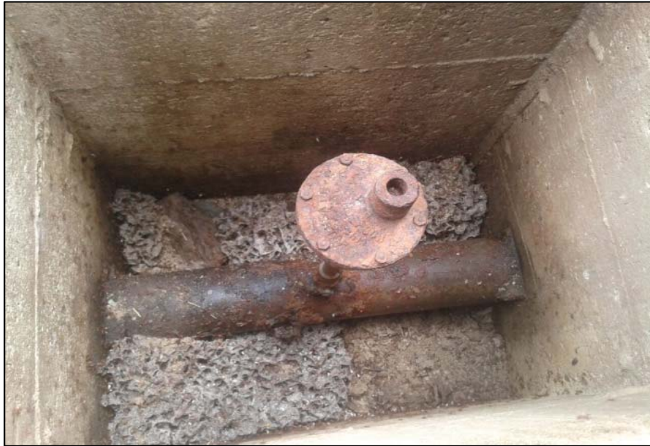
Figura 12. Accesorios y cambios de dirección tubería de aducción Dique toma sector La Manga.
