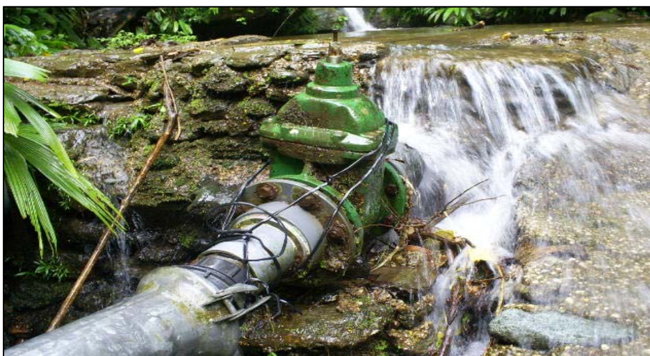
Figura 23. Valvula de paso hacia el canal de derivación Dique la Fabianera.
