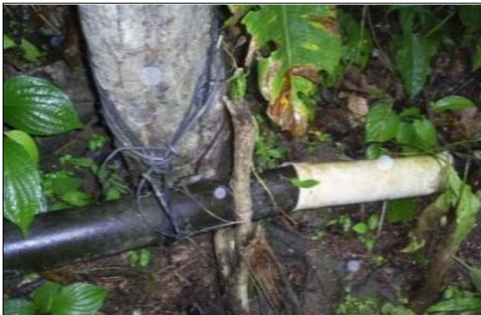
Figura 25. Apoyos de la tubería de aducción improvisados Dique la Fabianera.
