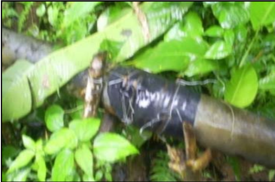
Figura 26. Reparaciones improvisadas en tubería de aducción Dique la Fabianera.
