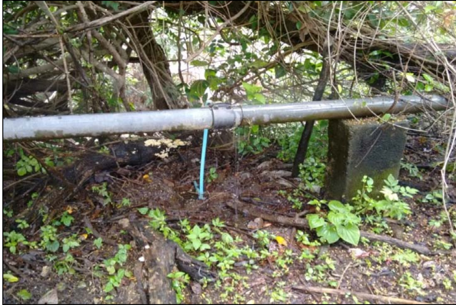
Figura 14. Tomas ilegales en tubería de aducción Dique toma sector La Manga
