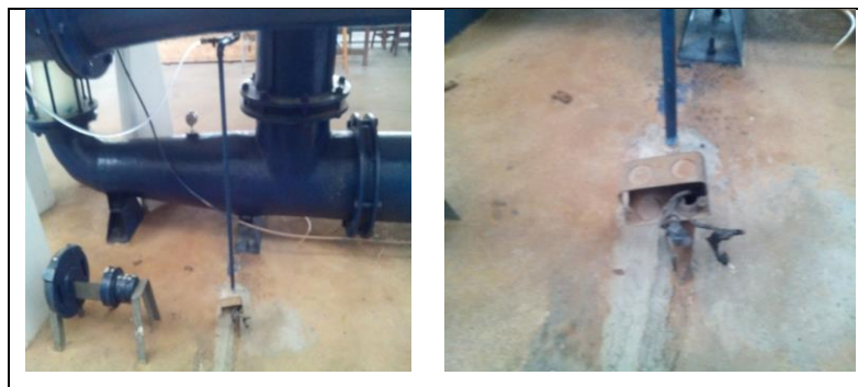
Figura 4.38. Cajetín en piso con alimentación trifásica.
