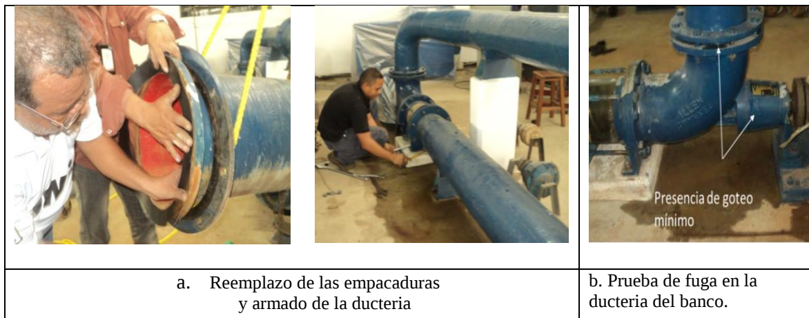
Figura 4.53.. Trabajos sin arranque en la ducteria, de la bomba axial.
