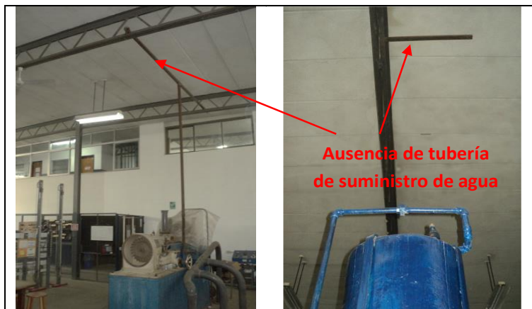
Figura 4.41. Línea de abastecimiento de agua a los bancos de turbinas.
