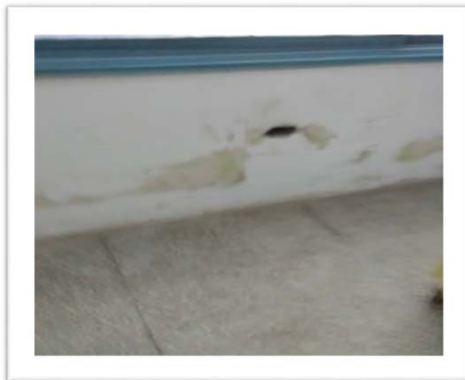
Fig. 16. Infraestructura dañada con material de remoción. Fuente: (González 2020)
