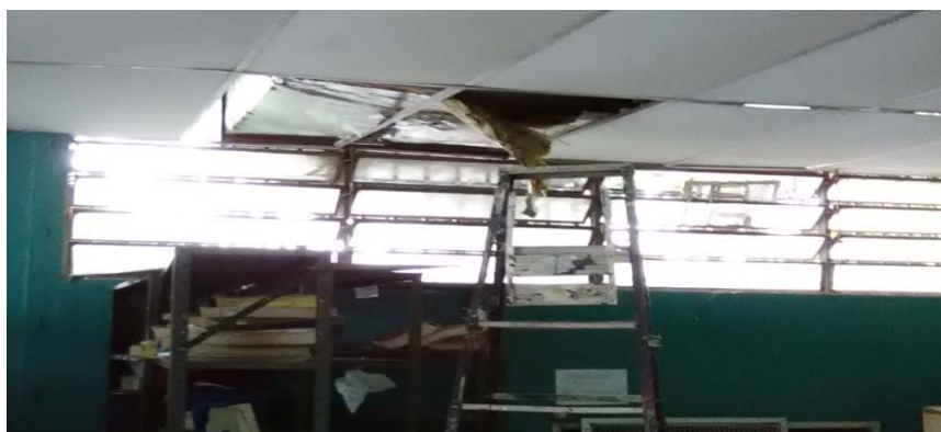
Fig.8 Inadecuada ventilación, con almacenamiento de colecciones expuesto a contaminantes y reparaciones postergadas. Fuente: González (2020)
