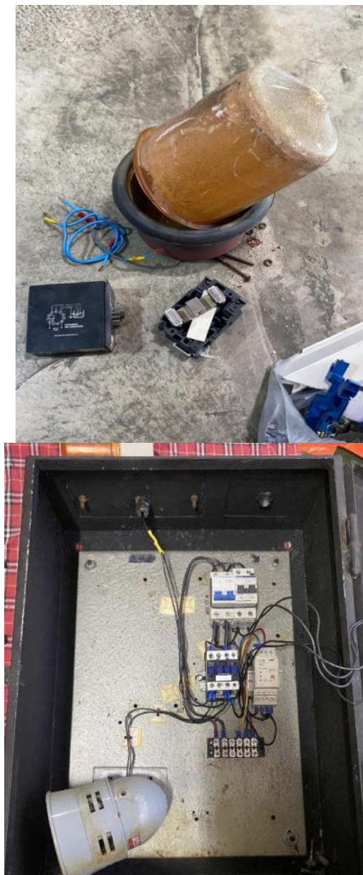
Figura 12. Evaluación de componentes dañados. Fuente: Colmenares I. (2023)
