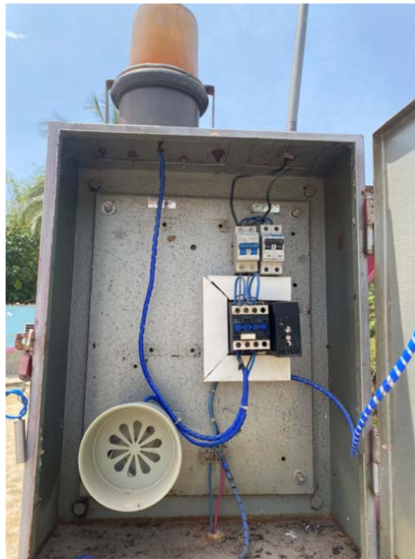
Figura 4. Estado inicial del tablero del SAT de la comunidad. Fuente: Colmenares I. (2023)
