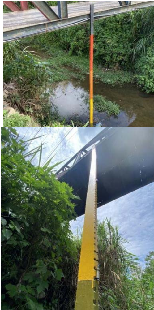
Figura 22. Limnómetro instalado. Fuente: Colmenares I. (2023)
