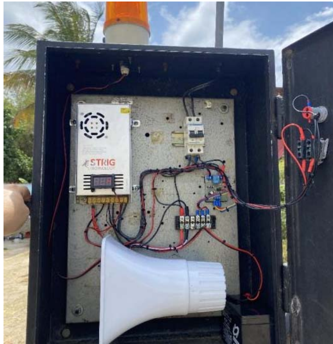
Figura 32. D.A.I.L.A. actualizado (nuevos componentes e instalación de batería)
