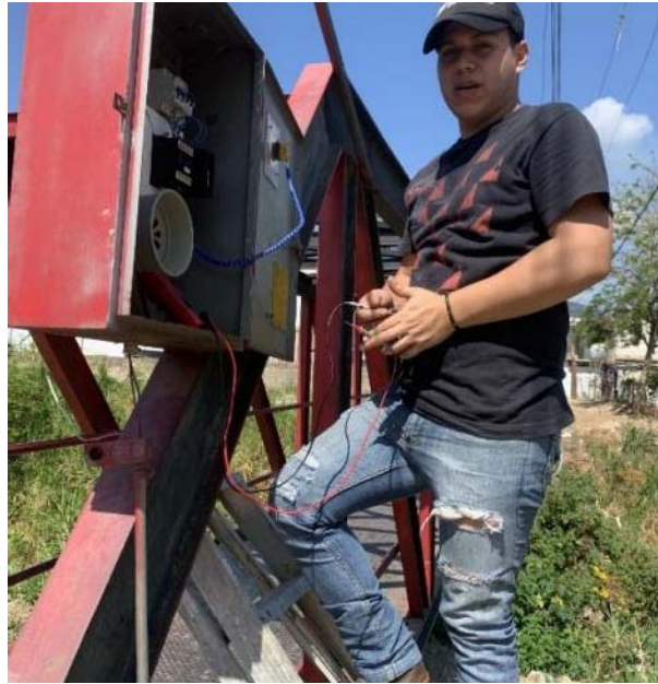
Figura 10. Inspección del funcionamiento del D.A.I.L.A.
